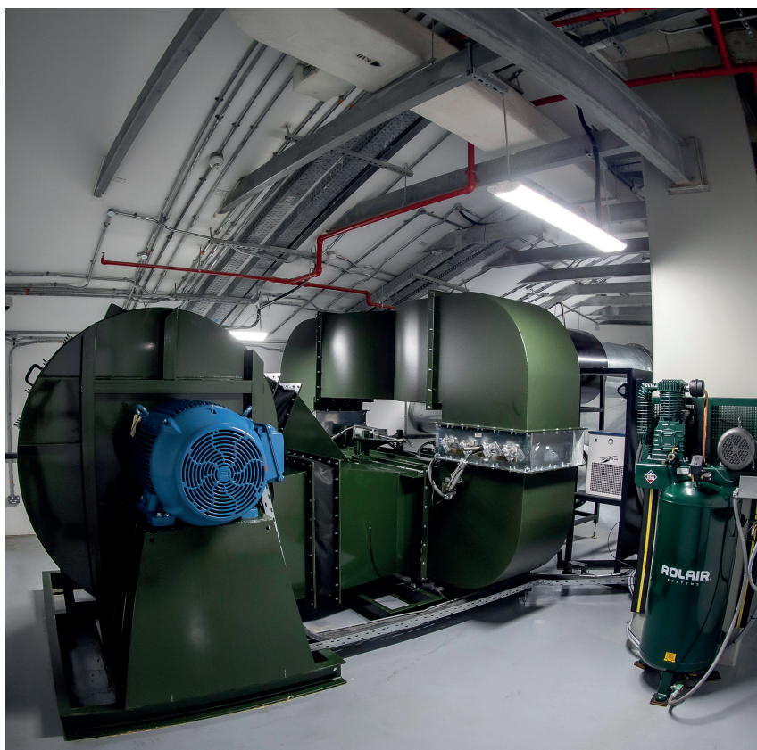
Strojovna Subair systému na Al Janoub Stadium.
